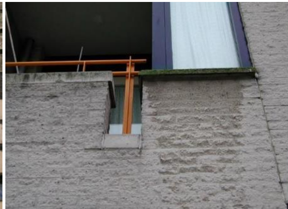
Atmosferisch vuil op gehydrofobeerde kalkzandsteen onder een raam (3.3.b)
