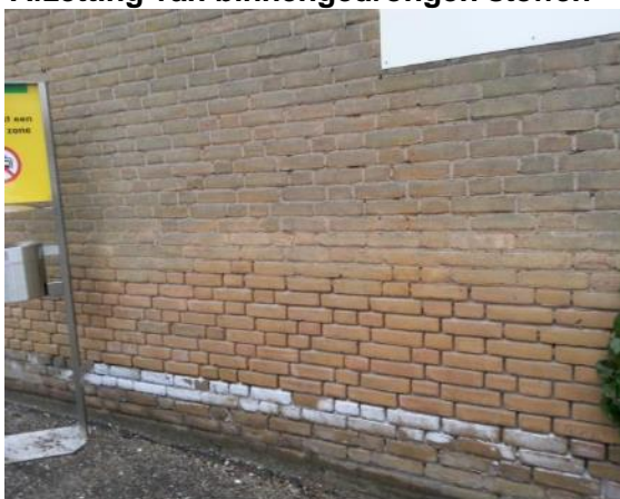
Witte uitbloei en schade aan voegwerk door dooizout (3.1.a)
