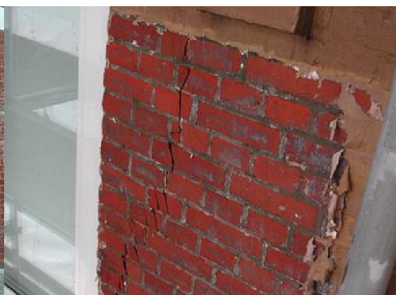
Resten van lijnolie op metselwerk na verwijderen van de verf (3.3.b)
