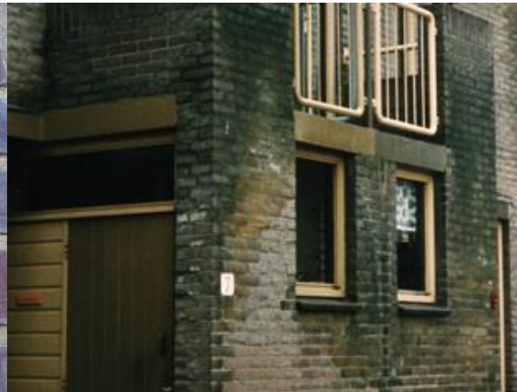
Vanadiumuitbloei in verschillende kleuren (3.4.b, 3.5.c)
