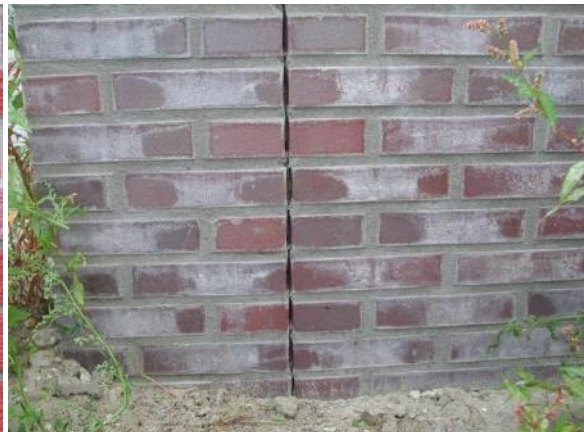
Witte afzettingen door uitloging van de metselmortel (3.1.b)
