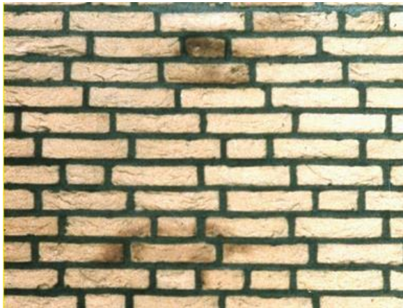
Bruine verkleuring door formaldehyde uit minerale wol (isolatie) (3.3.b)
