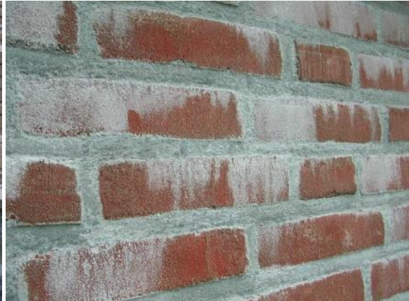
Uitspoelen van kalk uit vers voegwerk (3.1.b)
