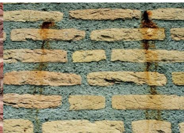
Roestende pyrietpitten in voegwerk (3.5.b)
