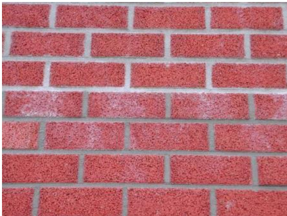
Kleurverschil in voegwerk door uitbloei van kalk uit de voegmortel (3.1.b)
