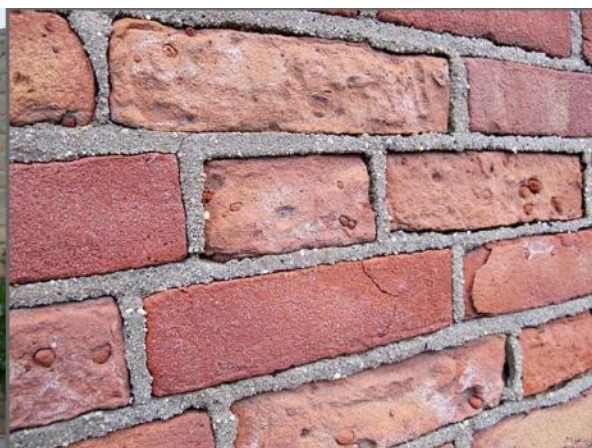
Schade aan metselwerk door binnengedrongen zeezout (3.1.a)
