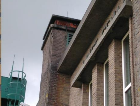
Vervuiling door roet (3.3.b)
